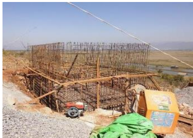
インレー湖の給水施設(タンク設置)
